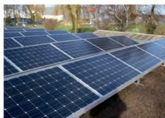
Bild 1 Solarpanels stehen unter Spannung, sobald die Sonne scheint.
